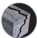
Pietra calcestruzzo fessurato
